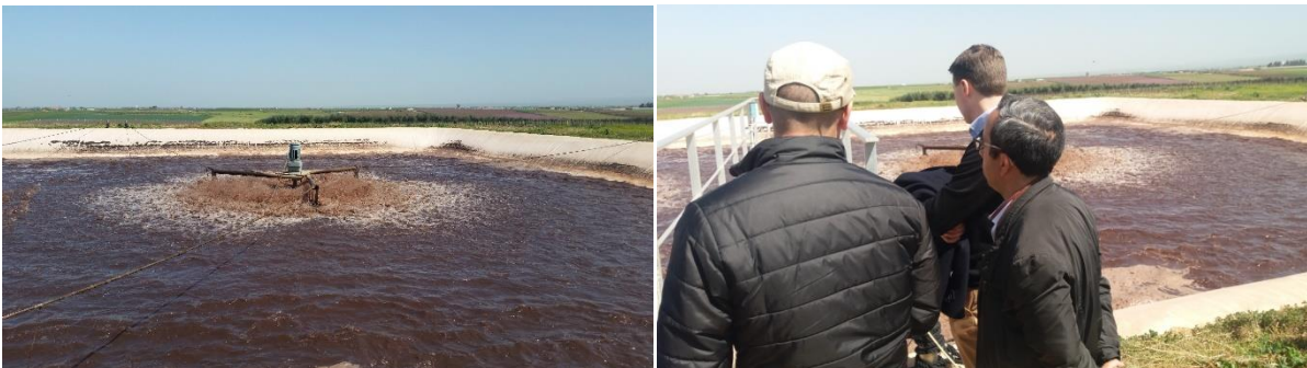
Station d'épuration des eaux usées de la société « Les Celliers de Meknès » pour le traitement des rejets liquides
